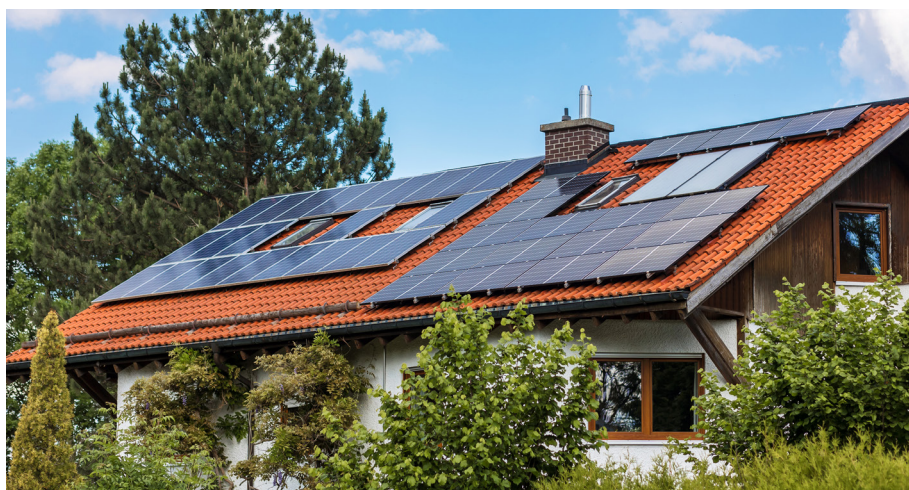
Zdjęcie 6: Panele fotowoltaiczne na dachu domu jednorodzinnego
