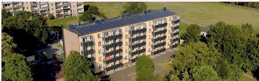
Zdjęcie 2: Panele fotowoltaiczne na dachu i balkonach bloku Wspólnoty Mieszkaniowej Śląska 12 15
